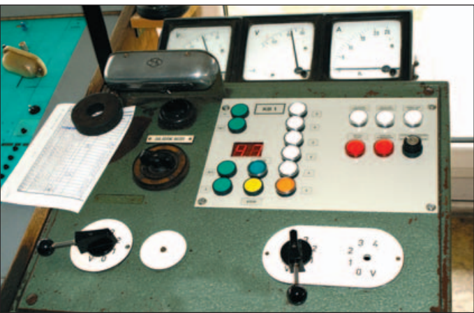
Původní ovládací skříňka kolejových brzd č. 1 a 2, doplněná o nové možnosti nastavení výstupní rychlosti z brzd a automatického řízení
