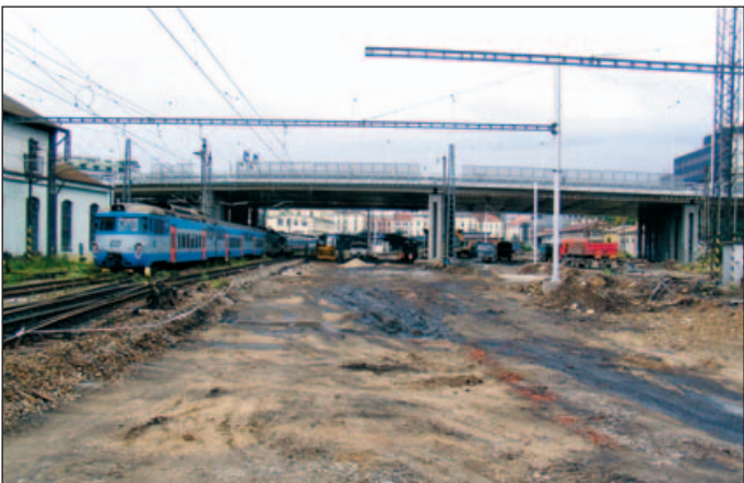
Pohled od tzv. místního dozoru směrem k odbavovacím budovám. Vlevo budova bývalého vozového depa. Po koleji vlevo odjíždí pantograf směrem Kolín.
