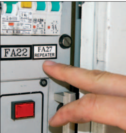
V ovládací skřínce vozu, kde se repeater zkouší, přibyl jeden štítek.
